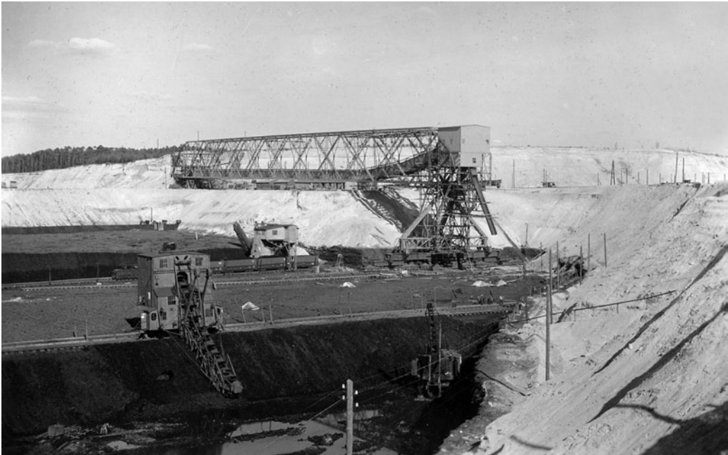
Montage der Abraumförderbrücke „Clara“ in der gleichnamigen Grube der „Eintracht Braunkohlenwerke und Brikettfabriken AG“ bei Welzow im Jahr 1930. Nachdem 1924 in der Grube „Agnes“ im brandenburgischen Plessa die weltweit erste Abraumförderbrücke errichtet worden war, entstanden im Lausitzer Braunkohlenrevier in rascher Folge derartige Tagebaugroßgeräte. (BAF Bestand 40200-3 Nr. S0597)
